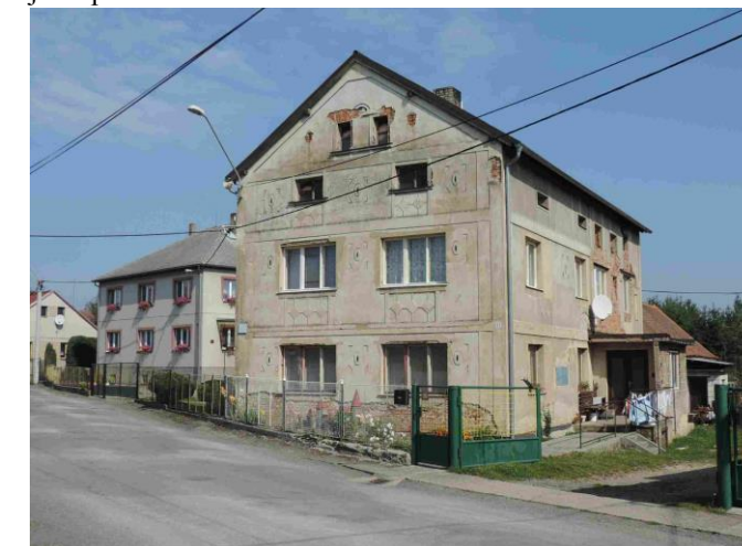
obr. č. C.613: Výrazná patrová hmotu v severní části sídla s nevhodně provedenou výměnou oken; původní členění je ještě patrné na fasádě
